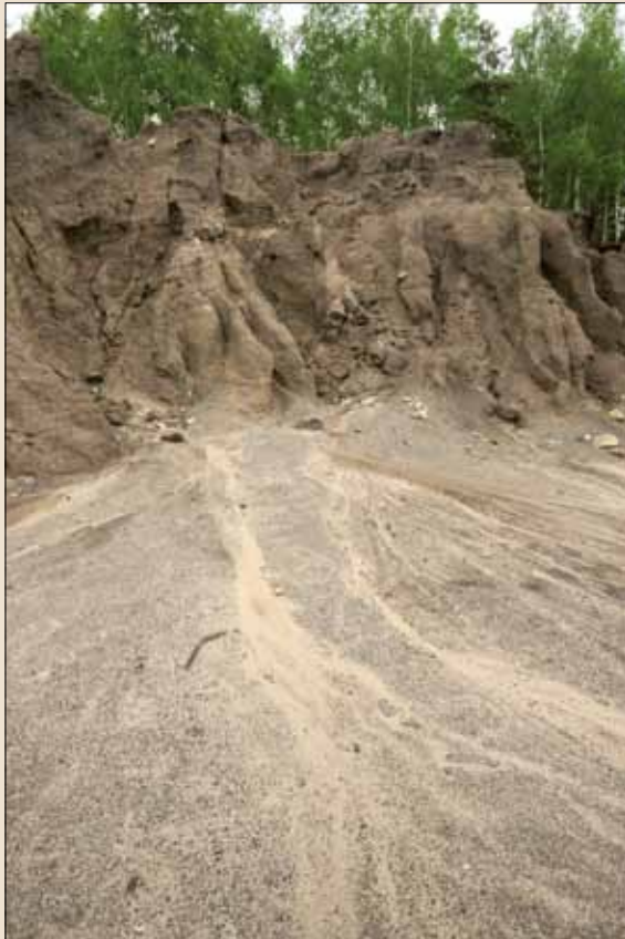
Geröllfächer des ausgespülten Materials an der Sohle der Böschung
